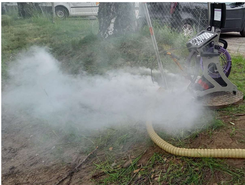
Kuva 12. Savutustilanne, jossa putkitukoksen vuoksi savu tulee lähtökaivosta ulos.
